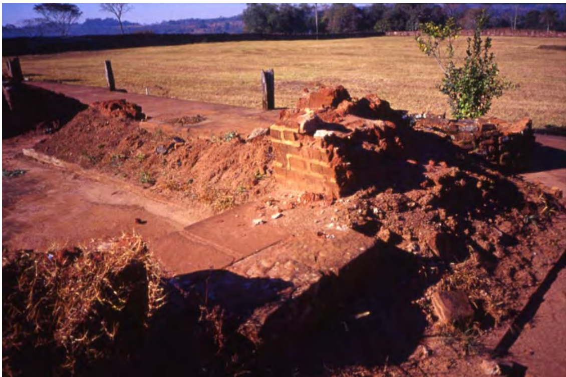
Fig. 2. Mala protección de muros en Trinidad, Paraguay (crédito autora, 1999)
