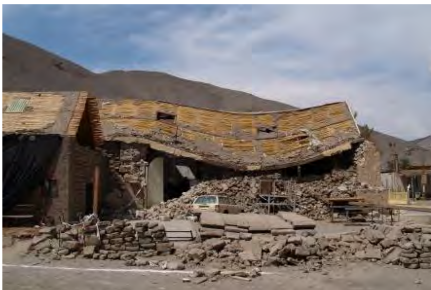
Fig. 1 - Imagen post-terremoto de 2005, de un inmueble de tierra restaurado con marco de hormigón armado (Iglesia San Lorenzo de Tarapacá)
