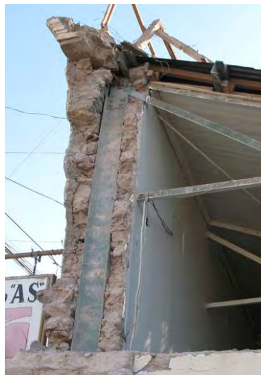
Fig. 5- Parte de la Pulpería, donde la caída del tímpano permitió descubrir la presencia de la estructura de hierro embebida en los gruesos muros de adobe. (Créditos: Surtierra Arquitectura, 2008)
