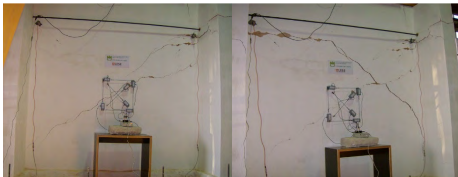
Fig. 1 - Início da fissuração (Pereira, 2008); Fig. 2 – Propagação e formação de novas fissuras (créditos: Pereira, 2008).
