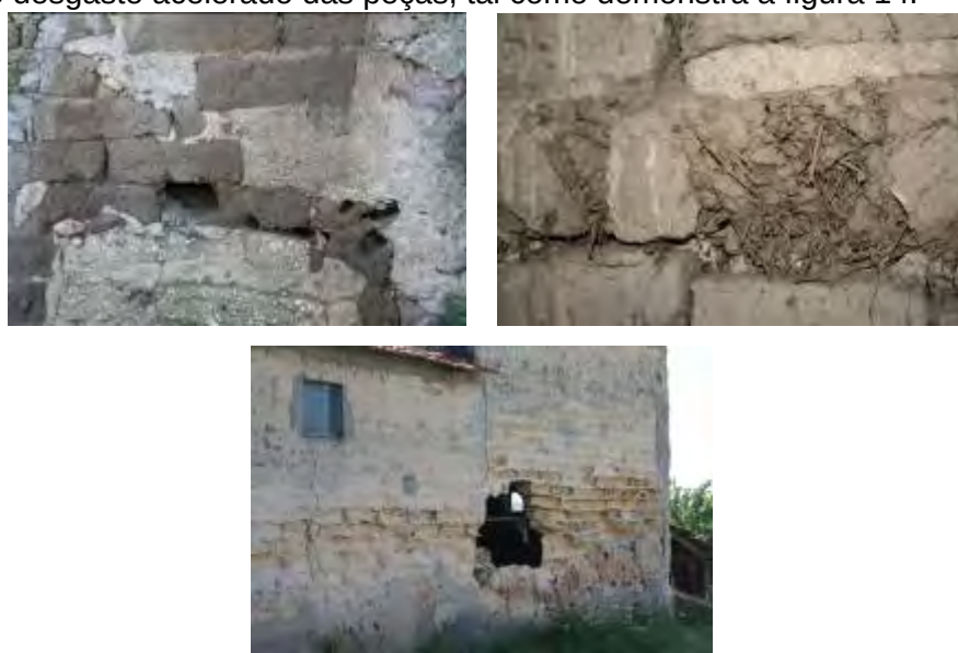
Fig.12, 13 – Formas de degradação - adobes de terra ( Requeixo ); Fig. 14 – Formas de degradação – adobes de cal ( Azurva ) (Crédito: Maia, 2009).
