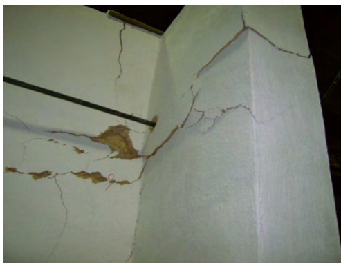
Fig. 3 – Danos observados na face interior da parede, junto ao apoio (créditos: autores 2009).
