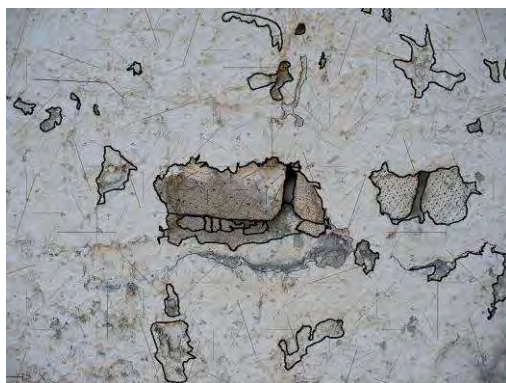
Fig.1 – Detalle de desprendimiento de revoque. (Paolo 2010)
