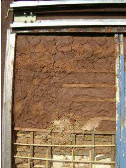
Foto 5 – Rachaduras apresentadas durante secagem do barreado.
