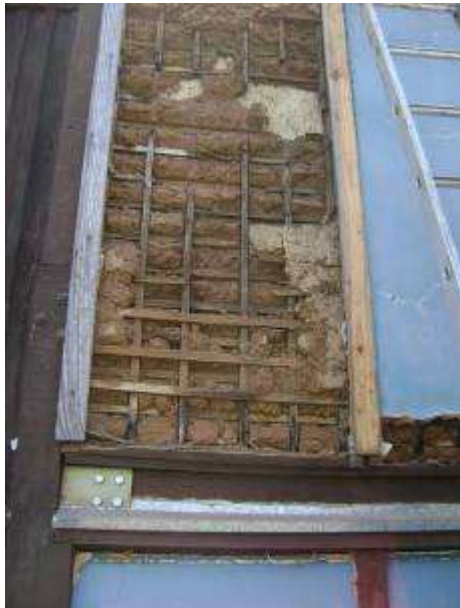
Foto 3 – Painel exposto após queda do barreado.
