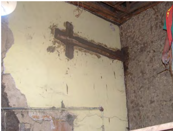
Figura 4. Llaves de madera en el nivel superior, entre muros de adobe y muros de bahareque. Crédito: Baquero, 2014
