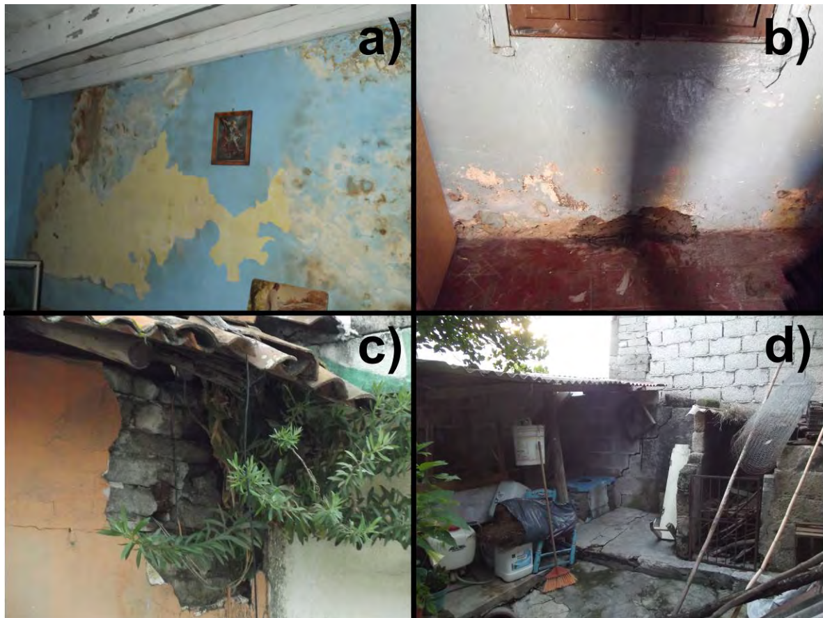
Figura 6. Tipos de problemas en las viviendas de adobe de Malinaltenango. a) Humedad y escurrimiento en muro; b) Agujeros de ratón tapados con cemento; c) Planta que creció en casa abandonada; y d) Cuarteadura en muro de bloques de hormigón, provocada por la cercanía a la barranca oeste.
