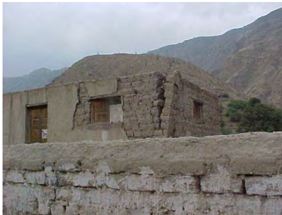
Figura 2. Grieta vertical en esquina superior de muro, Castilla, Arequipa, 2001. Crédito: D. Quiun
