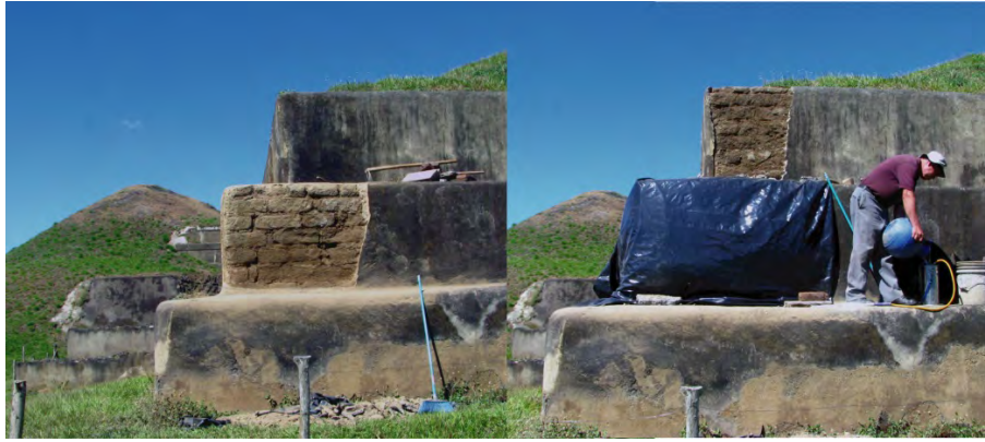
Figura 5– Partes dañadas en la esquina Sureste de la Estructura 2.
