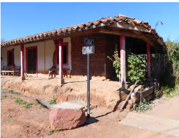
Figura 5. Estado original en deterioro
