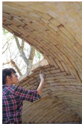
Figura 1. Trazo de las hiladas de las bóvedas de adobes recargados (Foto: L. Guerrero, 2015).
