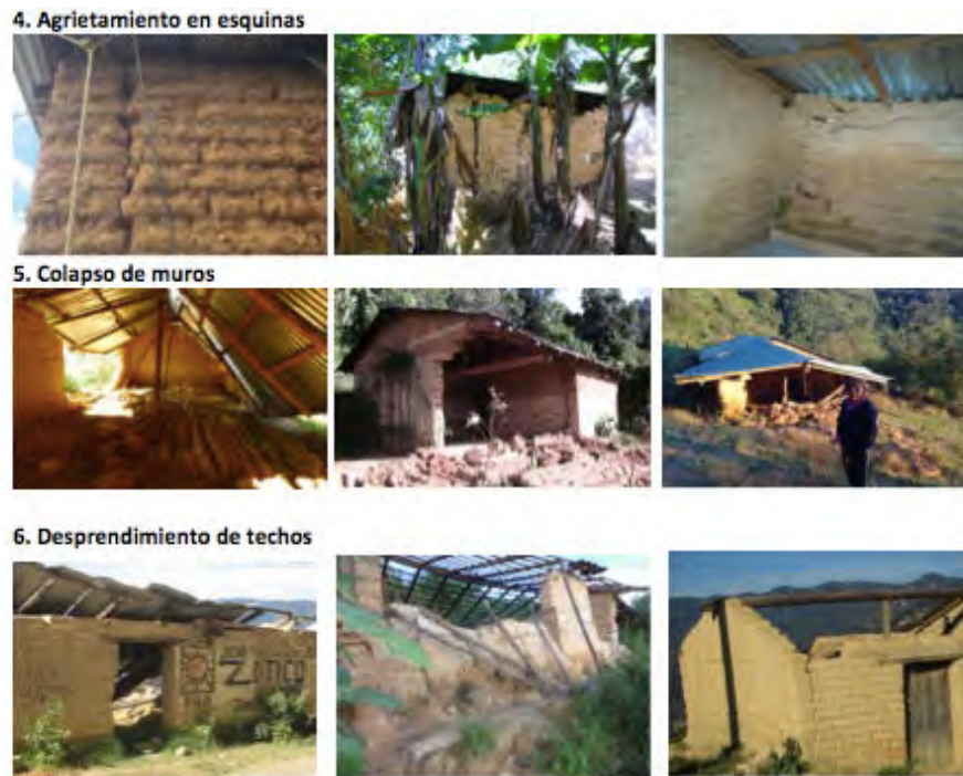
Figura 2. Fotografías del diagnóstico de daños en las viviendas de adobe
