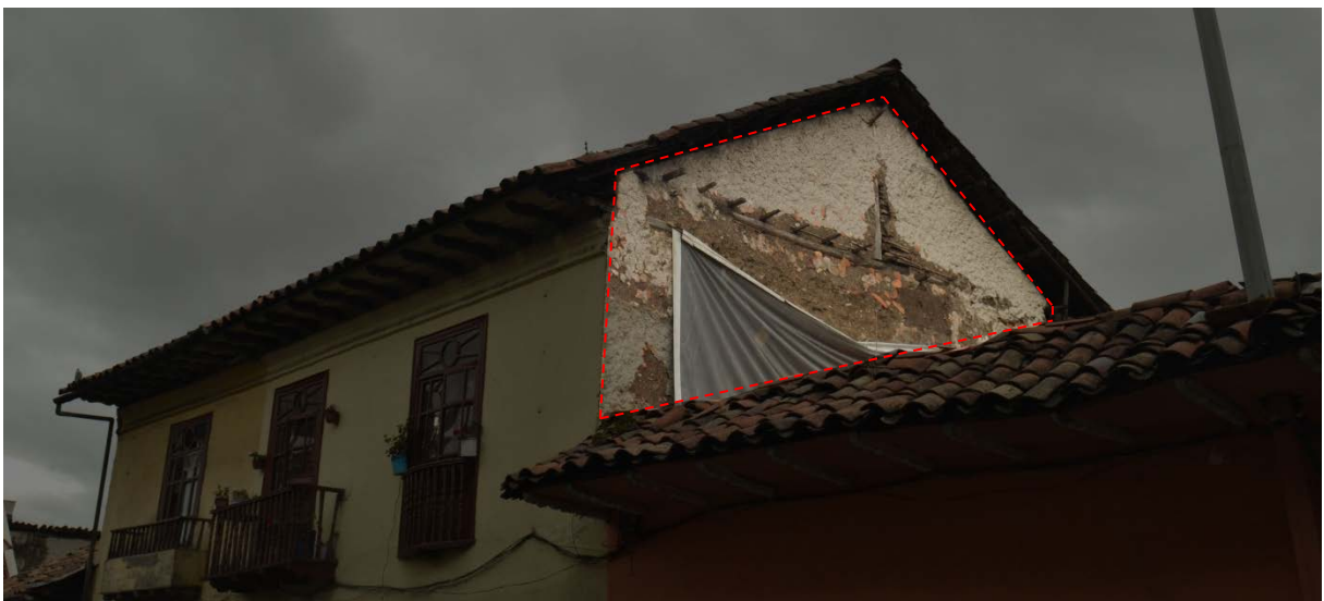
Figura 8. Edificación de bahareque que utiliza mortero de cemento para cubrir deterioros
