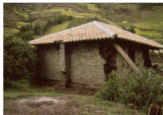
Figura 6 – Esquinas mal trabadas y sin refuerzo alguno, el contrafuerte falla por aplastamiento
