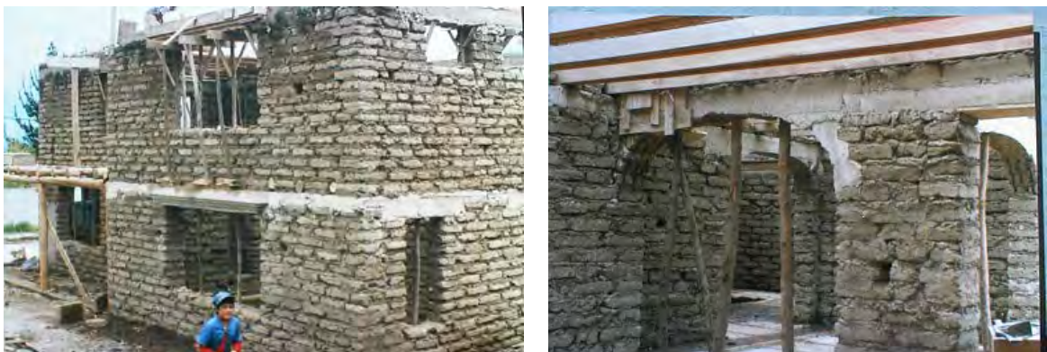
Figura 12 – Construcción con poca mampostería; esquinas poco estables; se puede intuir que tiene poca área de muros
