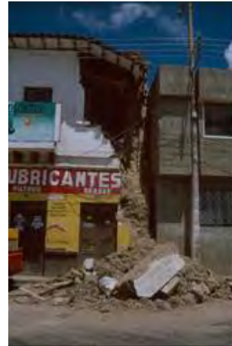
Figura 3 – Vivienda de hormigón construida junto a la de tierra golpeó y fracturó el muro de adobe
