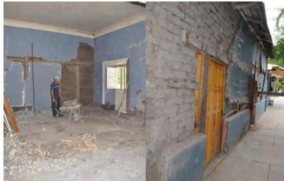
Figura 2. Daño vivienda, zona urbana poblado de Coinco, registro 2012
