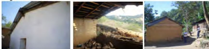
Figura 2. Fotografías del diagnóstico de daños en las viviendas de adobe (continúa)
