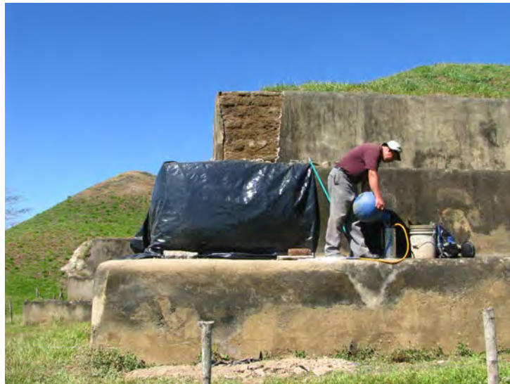
Figura 5. Partes dañadas en la esquina Sureste de la Estructura 2. (Foto O. Camacho 2014).
