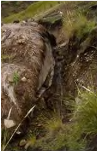
Figura 2 – Vivienda implantada muy cerca del talud. El deterioro del muro correspondiente al talud ocurrió debido al deslizamiento del suelo
