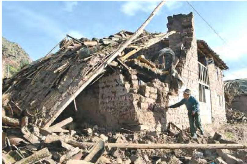
Figura 1. Vivienda colapsada en el distrito cusqueño de Paruro (Perú, 2014)
