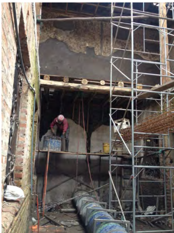
Figura 2. Cara interior del muro luego de la liberación de los baños en el nivel superior, el revoque de barro indica el resane de las áreas afectadas. Crédito: Baquero, 2014
