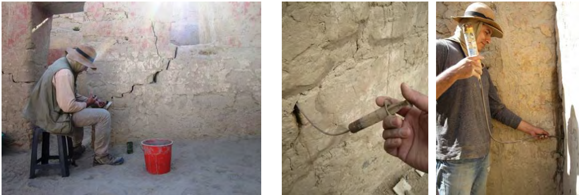
Figura 7 – Proceso de inyección del barro líquido en las grietas, se usaron instrumentos para ejercer presión o por gravedad. Fotos: Proyecto Tambo Colorado (2014)
