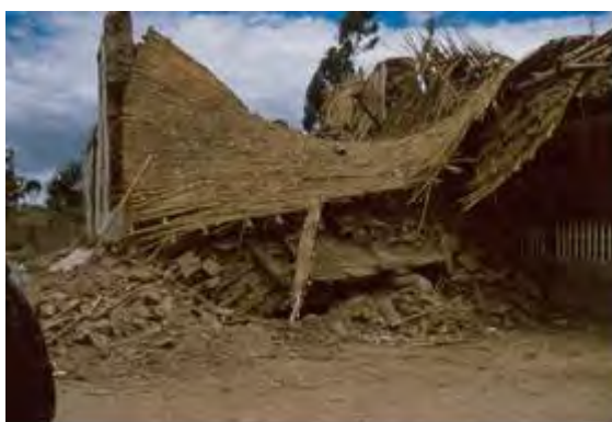
Figura 5 – Ausencia de refuerzo en los muros
