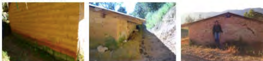
3. Agrietamiento en dinteles
