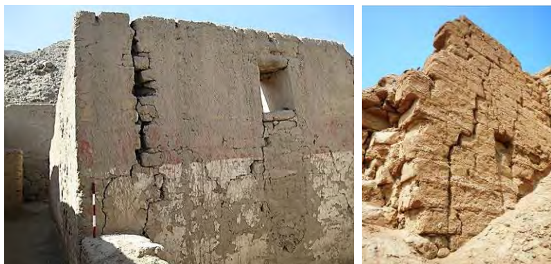
Figura 1. Vista de muros arqueológicos de tierra con agrietamientos que afectan su estabilidad
