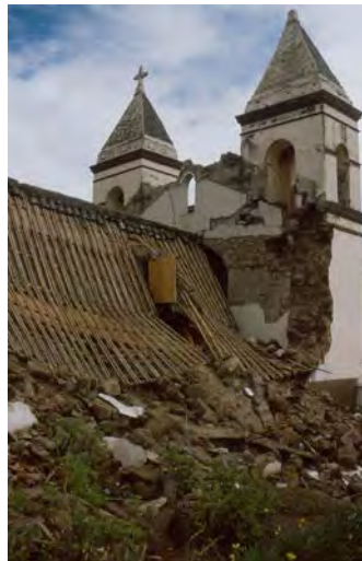
Figura 10 – La cubierta desplaza a los muros provocando su colapso
