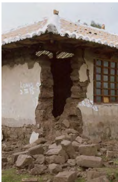
Figura 7 – Esquinas con defectos por trabajos de albañilería
