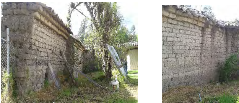
Figura 1 – Muro 1: Cerramiento del Hospital Mariano Estrella, mayo 2015
