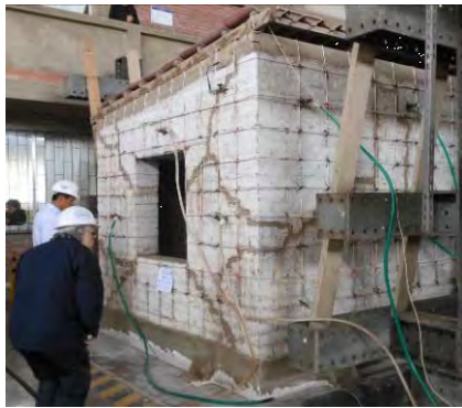
a) Inspección de daños
