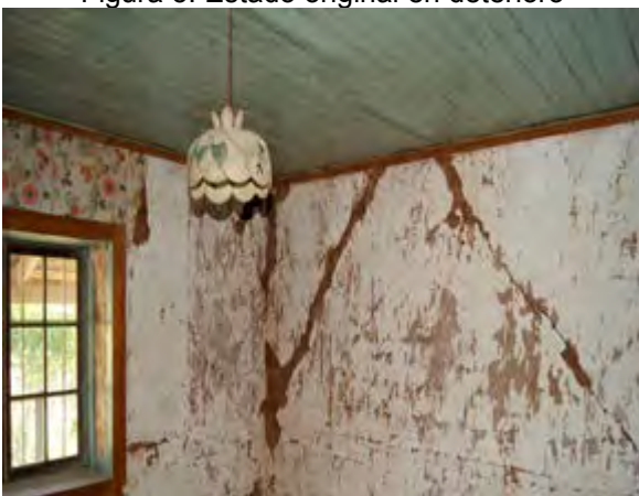
Figura 7. Grietas en muro dormitorio
