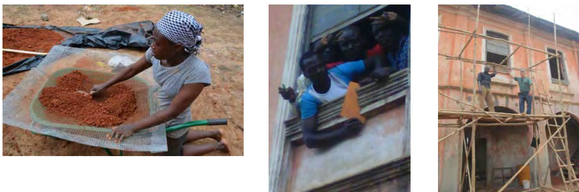
Figura 6: Seleção e beneficiamento da terra; Execução de moldes – carrinhos deslizantes – para execução das cimalthas e molduras; Construção e montagem dos andaimes (Créditos: Pedro Paulo Vitor, 2012)
