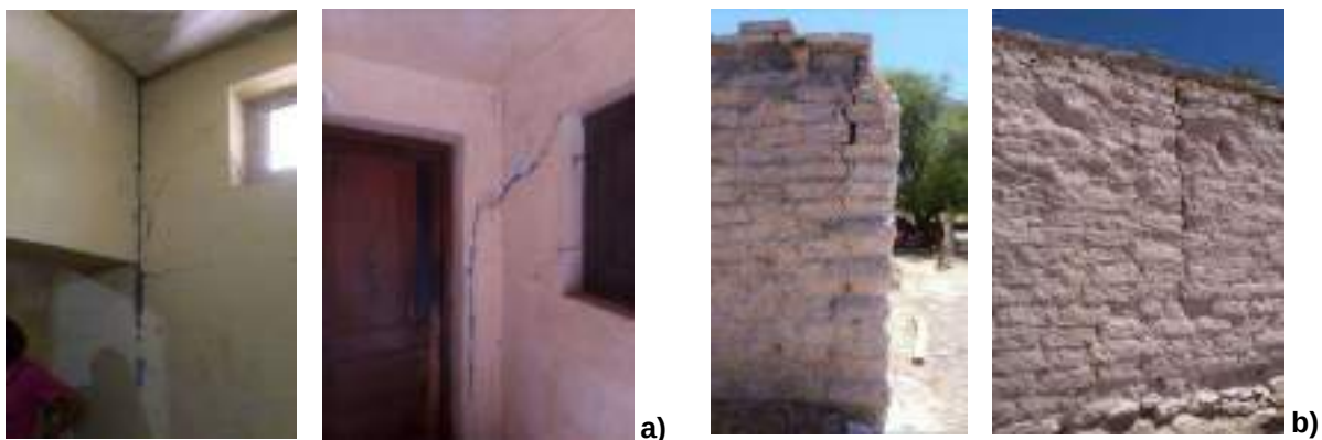
Figura 3. Fisuras y grietas. Departamento Pocito a 25 km del epicentro del terremoto: a) área Suroeste; b) área Noroeste
