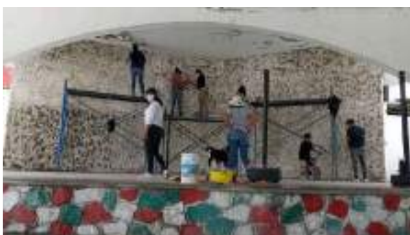
Figura 13. Puente de agarre para revoque de tierra en Huatecalco. Crédito: Alexis Yael
