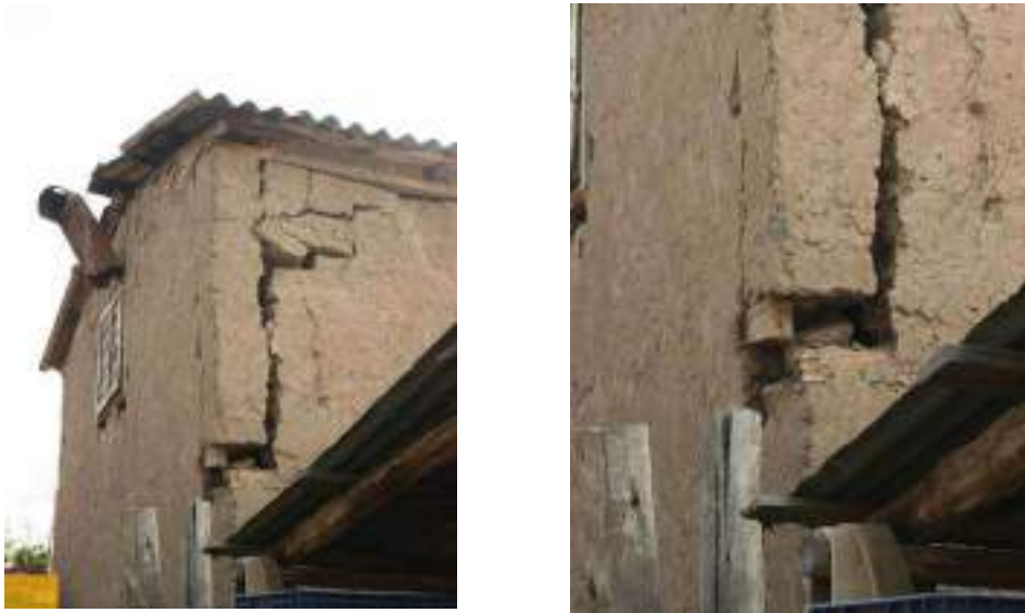
Figura 7. Daño de horno en Panguesillo, asociado al vínculo deficiente entre los elementos de refuerzo horizontales de madera
