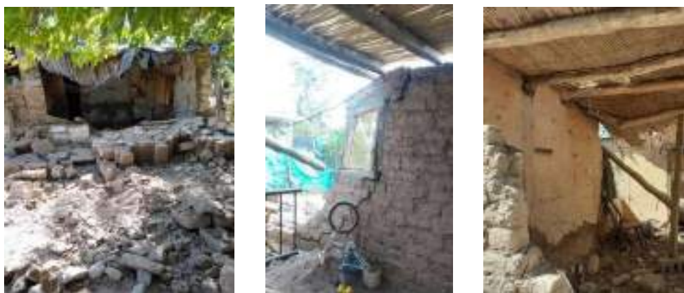
Figura 7. Colapso de edificaciones a Suroeste del departamento Pocito (crédito: Municipio de Pocito)
