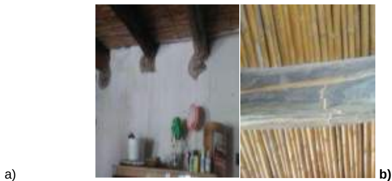
Figura 6. Daños en cubiertas superiores. Departamento Pocito: a) área Suroeste a 27 km del epicentro del terremoto (crédito: Municipio de Pocito); b) viviendas al Noroeste a 28 km del epicentro del terremoto
