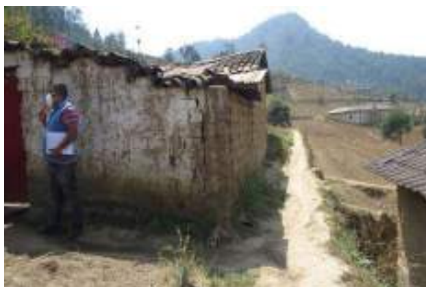
Fig. 4. Vivienda de adobe con grieta en una de sus paredes. Fuente: Méndez, 2020
