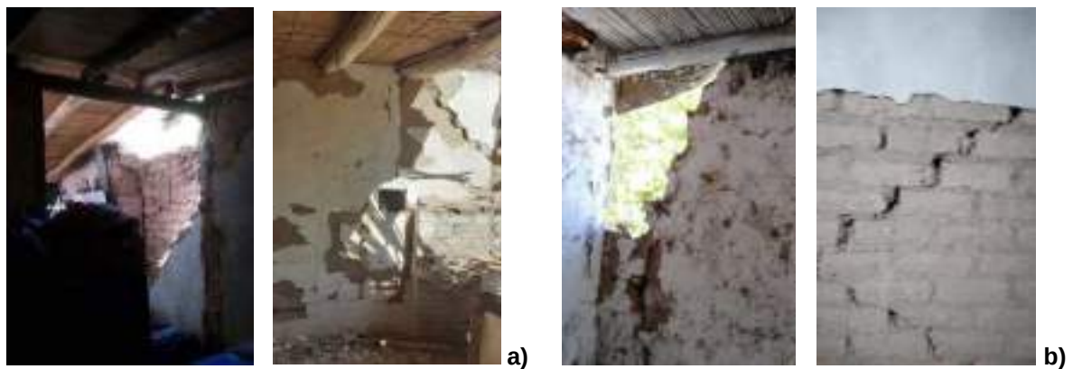
Figura 5. Deformaciones y fisuras de muros. Área Suroeste del Departamento Pocito. a) a 25 km del epicentro del terremoto; b) a 24 km del epicentro del terremoto
