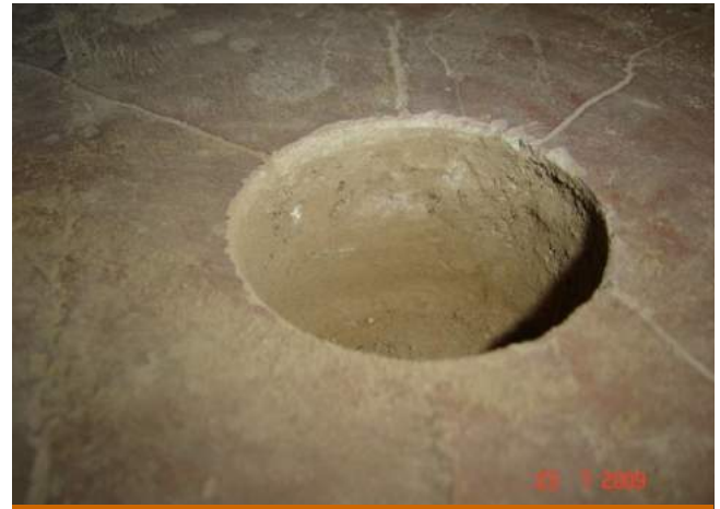
Figura 6. Condiciones de las fisuras del piso. Fuente: F.J. Quiñónez (2009).
