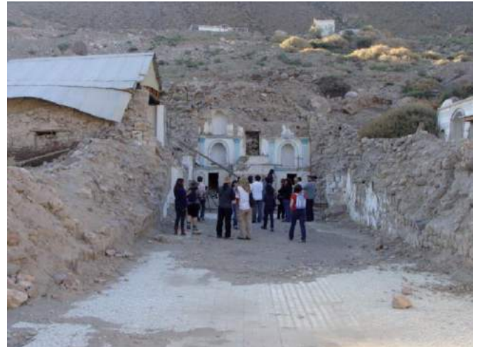
Figura 4: Interior de la iglesia de Sibaya después del terremoto del 2005. (Fuente: Elaboración propia, 2014, y Archivo Consejo de Monumentos Nacionales, 2010).
