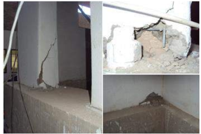
Figura 6. Daños observados al final del ensayo en el modelo reforzado.
