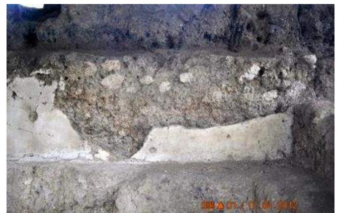
Figura 5: Detalle de la fachada este del Edificio K donde se observa los cantos de pómez como parte del sistema constructivo. Fotografía por D. Juárez
