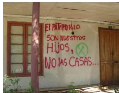
Figura 1 – Inmueble marcado con una cruz verde por los equipos de emergencia indicando su inhabitabilidad, y con un mensaje escrito por los habitantes del poblado de Lolol tras el terremoto del 2010. (Fuente: Consejo de Monumentos Nacionales, 2011)
