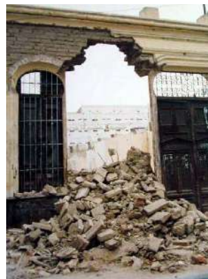
Fig. 10b – Falla por volteo.
