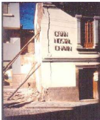
Fig. 10a – Agrietamiento de esquina.
