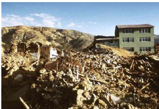
Fig. 1 – Colapso total de viviendas de tierra.
