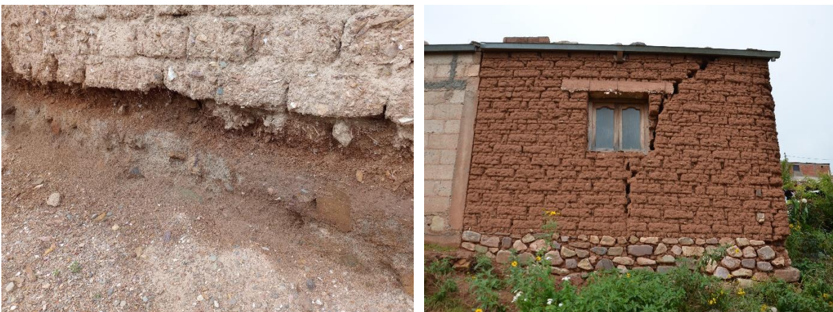
Figura 7. Degradación en la base de un muro en Susques, a la izquierda, y daño estructural asociado con un vano en Nazareno, a la derecha
