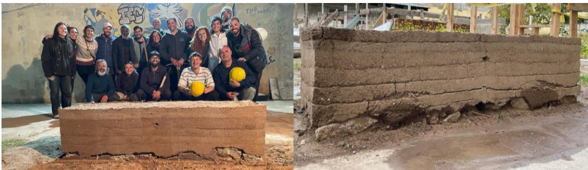
Figura 6. A la izquierda, finalización del prototipo ejecutado en el segundo taller, octubre de 2023. A la derecha, el mismo prototipo luego de dos semanas de su ejecución (crédito: C. Briño y C. Varin)
