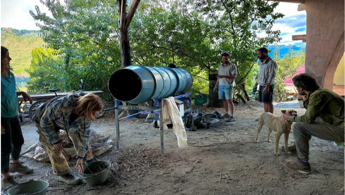
Figura 3. Lugar de las prácticas de escuela DeBarro con una herramienta específica del aporte tecnológico a la construcción con tierra. Máquina mezcladora de paja/tierra arcillosa
