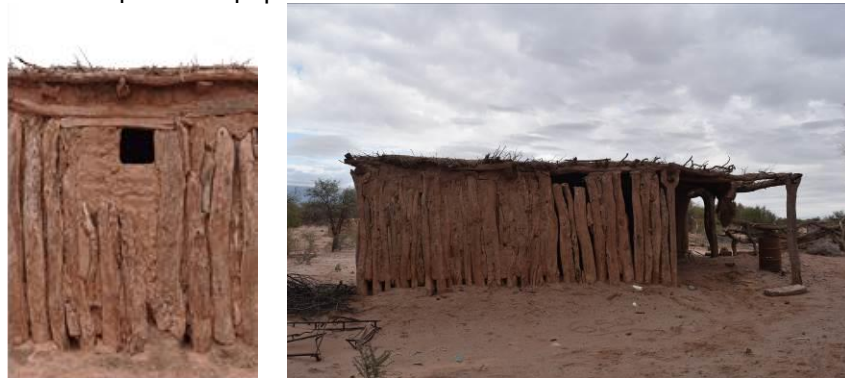
Figura 8. Erosión en la base de los cerramientos verticales y desprendimientos del material del relleno de arquitectura popular de Bañados del Pantano
