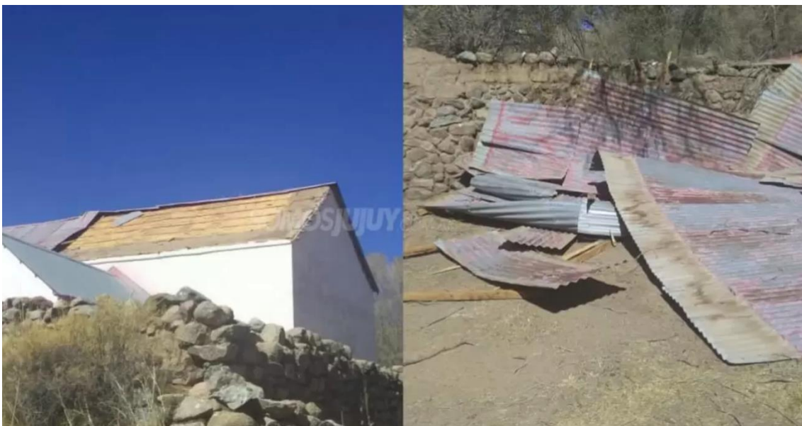
Figura 3. Chapas de la cubierta luego del temporal (fuente: diario digital Somos Jujuy)
