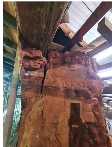
Figura 8. Fotografía del muro quebrado, tal como se visualiza en la figura anterior
