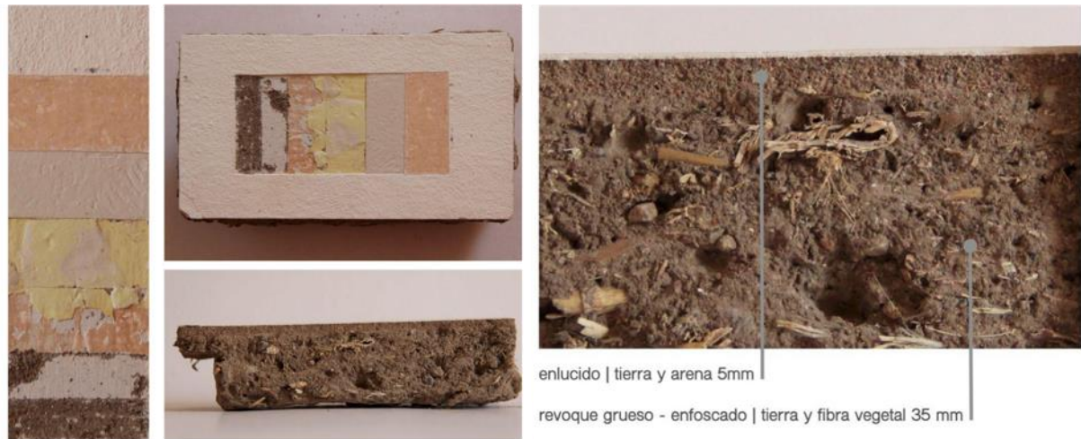
Figura 8. Terminación interior del Convento Corazón de María de Ovalle (OVA02A). Izquierda y arriba al centro: levantamiento estratigráfico que muestra diferentes capas de acabados de cal y pinturas vinílicas. Centro abajo y derecha: sección que muestra 5 mm de enlucido de tierra y arena y 35 mm de enfoscado con tierra y fibra
