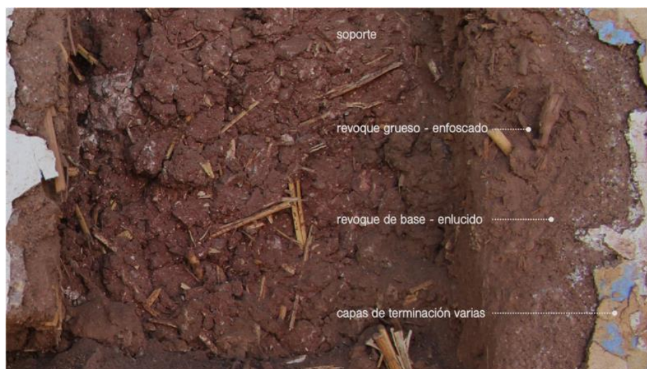
Figura 5. Capas del sistema de revestimiento: estructura de muro de adobe (soporte), primera capa de tierra y paja (enfoscado), segunda capa de mezcla de tierra y arena (enlucido) y diversas capas de terminación. Combarbalá, muestra COMB02A
