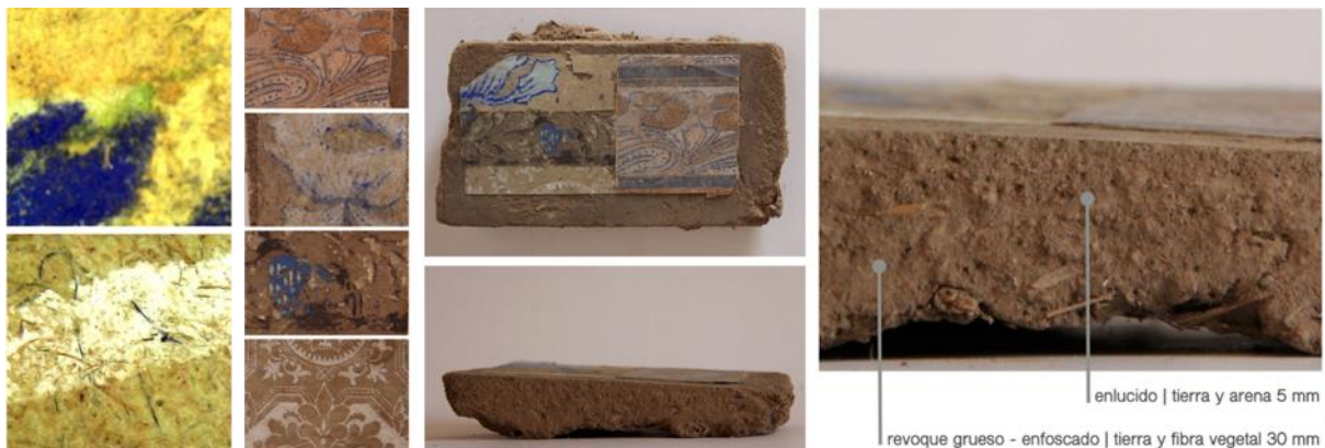
Figura 9. Acabado interior de una hacienda abandonada en Barraza (BARR01BB) con varias capas de papel mural
