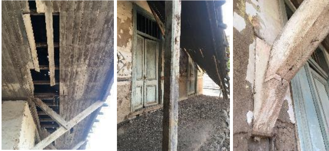
Figura 4: Imágenes del estado de deterioro ex estación de tren Pelicana. Fotografía registrada en viaje exploratorio, en febrero del año 2020
