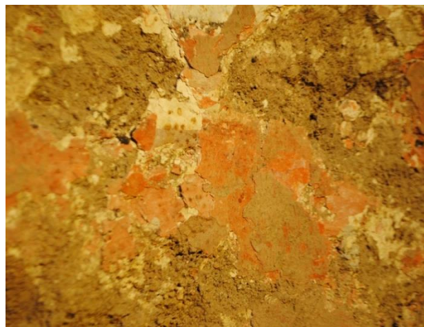
Figura 7. Detalle de aplanado de tierra y capas de pintura de cal sobre muro de mampostería de piedra en edificación ubicada en la Región Sierra Central, en el centro histórico de la ciudad de Guanajuato, México
