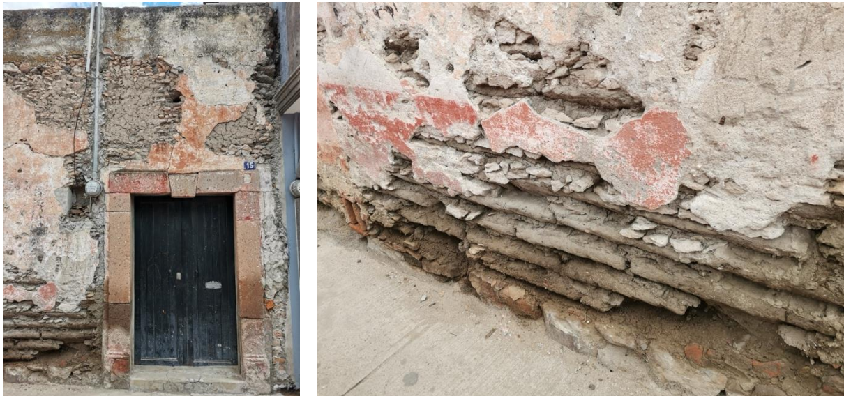
Figura 8. Aplanados de mortero de cal, con integración de pedacería de piedra y elementos de barro cocido sobre muros de adobe de vivienda localizada en la Región Sierra Central, en la cabecera municipal de Comonfort, Guanajuato, México
