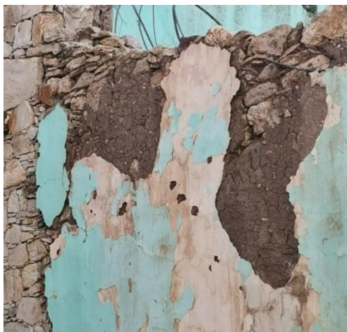
Figura 6. Aplanados de tierra y capas de pintura de cal sobre muro de mampostería de piedra asentada con mortero de tierra, Región del Bajío, Pénjamo, Guanajuato, México
