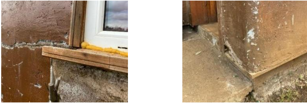
Figura 18: Ejemplo de filtración de agua en muros de quincha en Vivienda Origen
