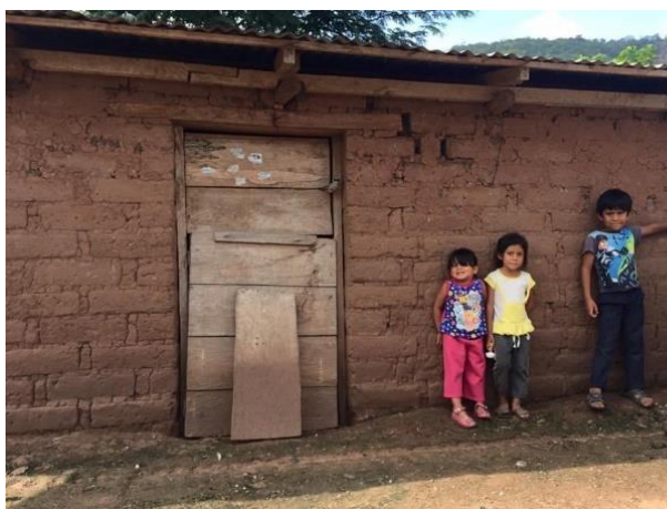
Figura 1. Vivienda de adobe sin revoques y rodapié, Francisco I. Madero, Jiquipilas, Chiapas, 2017
