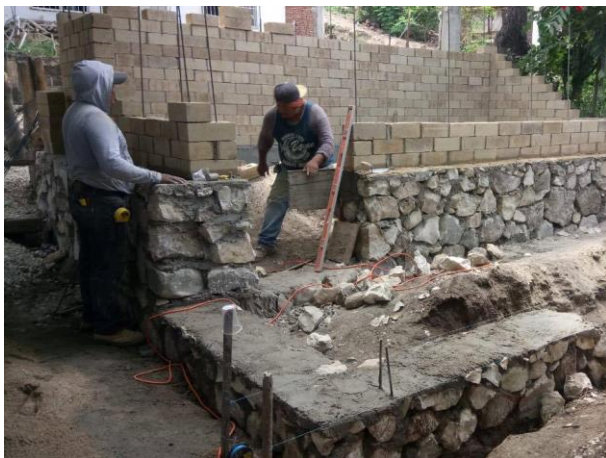
Figura 3. Proceso de construcción de vivienda con BTC y piedra del lugar en la localidad Los Sabinos, Berriozábal, Chiapas, 2018
