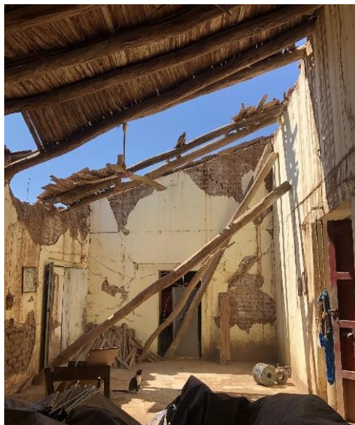
Figura 3. Daños en vivienda de adobe, Istmo de Tehuantepec, Oaxaca, 2017. (Fuente: Cooperación Comunitaria A. C.)
