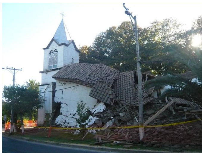
Figura 3. Iglesia de Guacarhue post-terremoto, año 2010
