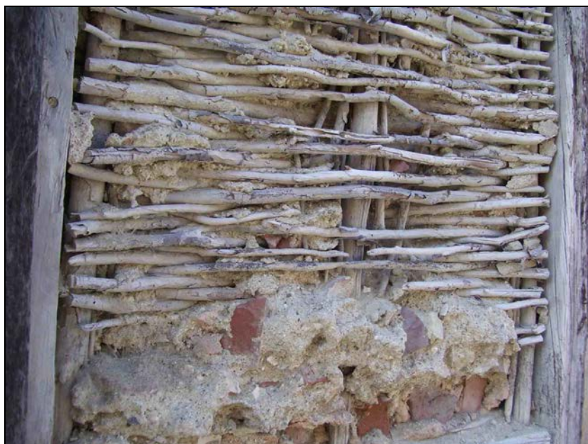
Figura 5. Lesiones en el tipo constructivo 1
