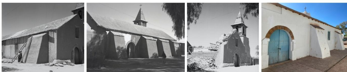
Figura 5. Refuerzos mediante contrafuertes en intervenciones de 1952 y 1954. Colapso del sistema y situación actual del muro y contrafuertes. (créditos: Montandon,1952,1954,1957; Valdivia, 2022)
