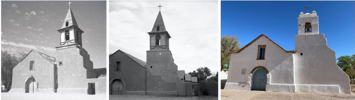
Figura 4. Representación de la situación anterior (con grietas), la intervención efectuada (enlucido nuevo) y la situación actual de la torre (créditos: Montandon, c.1950,1952; Valdivia, 2022)
