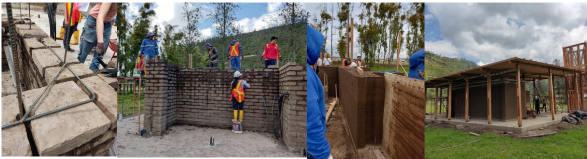
Figura 5. Proceso constructivo de los componentes de tierra del laboratorio multifuncional en la PUCE-I
