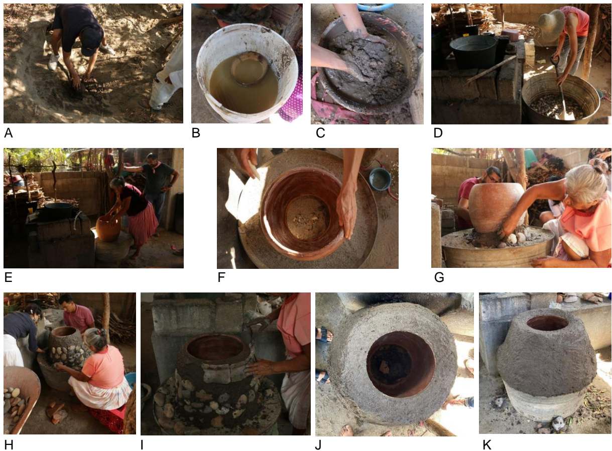
Figura 6. Secuencia constructiva del horno- pow . (acervo del LABPySCT, fotografías de Paul Castillo, Zita Ávila y Ángeles Vizcarra)
