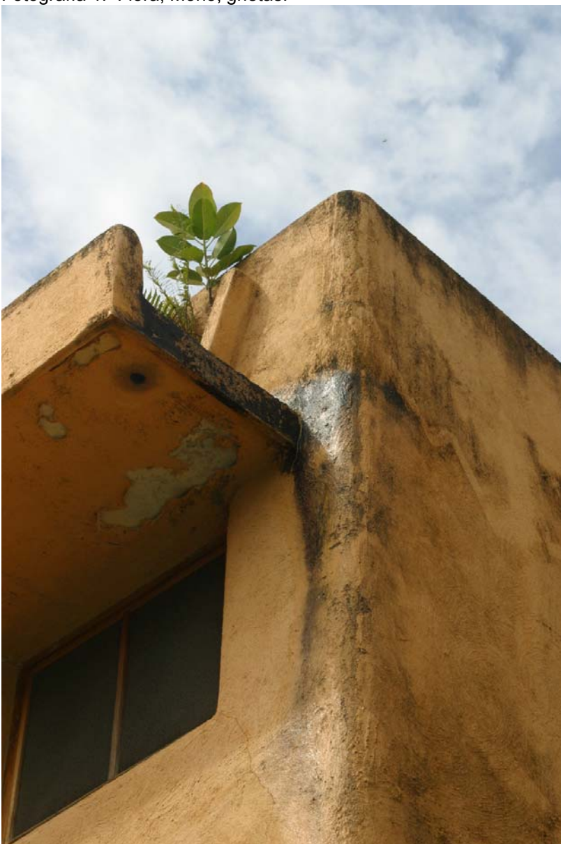
Fotografía 1. Flora, Moho, grietas.
