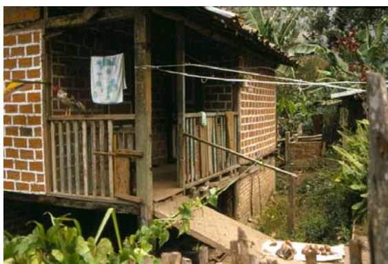
Figura 6 – Vivienda de ladrillo. Infestada
