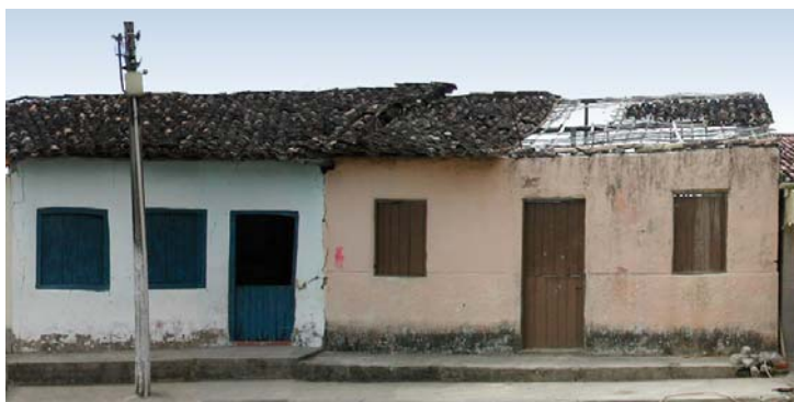
Figura 6 – Casas térreas (em taipa) já vilipendiadas pela não conservação sistemática das cobertas
