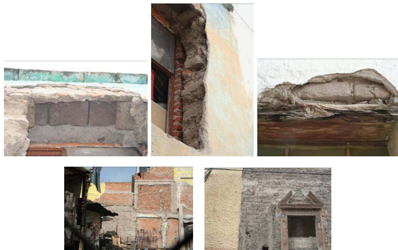
Figura 5 – Detalles del confinamiento del adobe por el ladrillo, cerramientos de madera para soportar el adobe y preparación con malla de gallinero para el repellido
