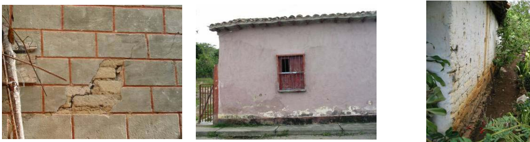
Figura 4 – Desprendimiento, eflorescencias y humedad localizada
