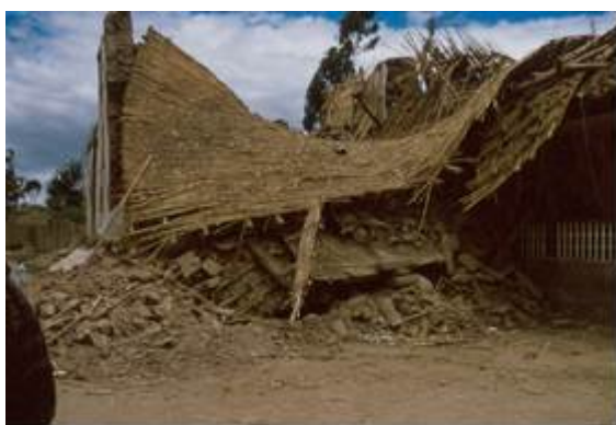
Figura 5 – Ausencia de refuerzo en los muros
