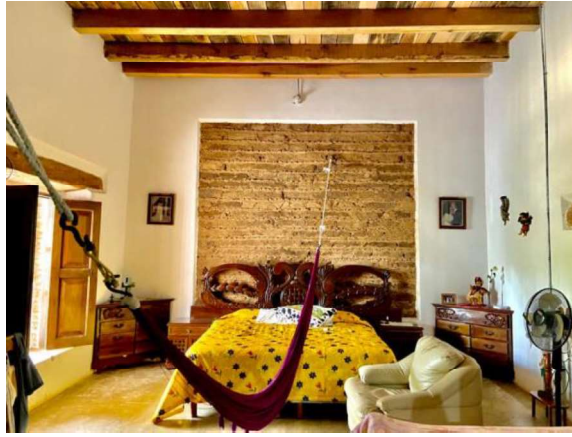
Figura 5. El Horizonte, consolidación de muros, vigas tensoras y alfarjes (falso plafón), crédito: CONAVI
