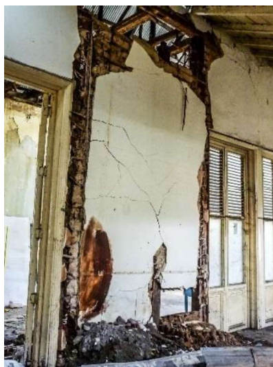
Figura 5. Deterioro presentado en los muros de bahareque de la Quinta Teresa antes de su restauración integral
