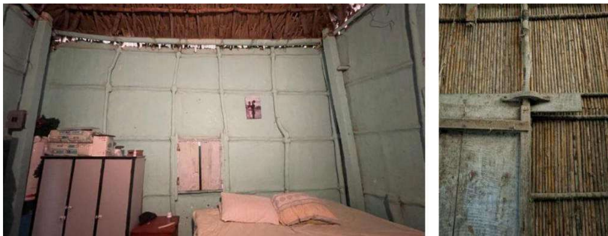
Figura 5. (izq.) muro de bahareque de vara parada visto desde el interior de la vivienda con revestimiento (der.) sin revestimiento
