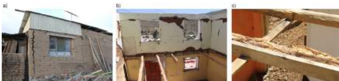
Figura 8. Daños graves en construcción de adobe nuevo . Evaluación de daños a los diez días del sismo (Fuente: Amanda Rivera y Cristian Muñoz en 2015).
