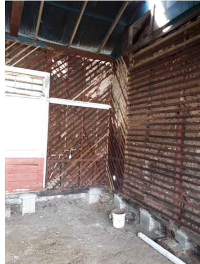
Figura 10. Revisión unión al vuelco de viga solera basal
