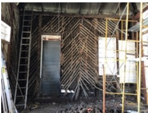
Figura 6. Estado inicial. Piso de concreto cubriendo estructura de madera propiciando daños en la base. (Crédito: M. B. Esquivel, 2018)
