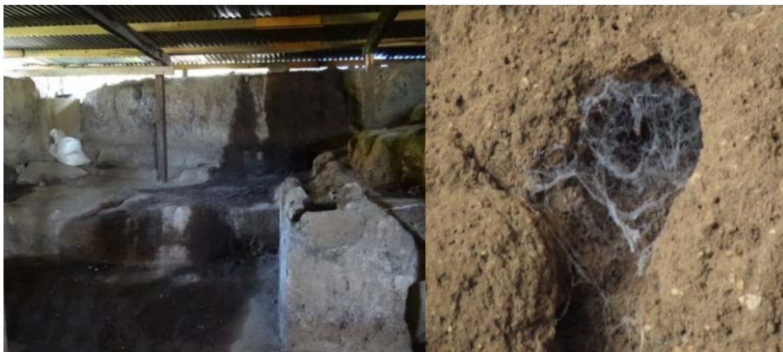
Figura4. Daños en estructuras expuestas: Filtraciones de agua en la Acrópolis y nidos de artrópodos en perfiles (crédito: J. Alvarez, 2016)
