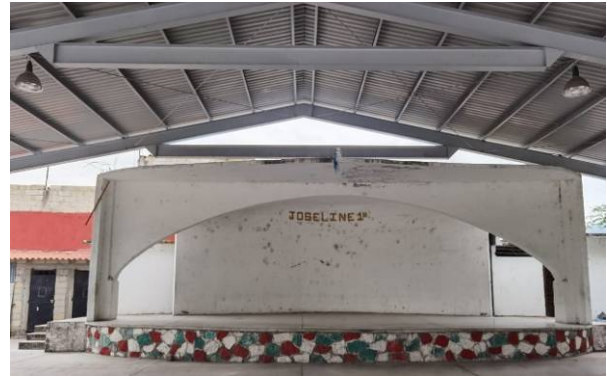
Figura 10. Muro en el auditorio de Huatecalco
