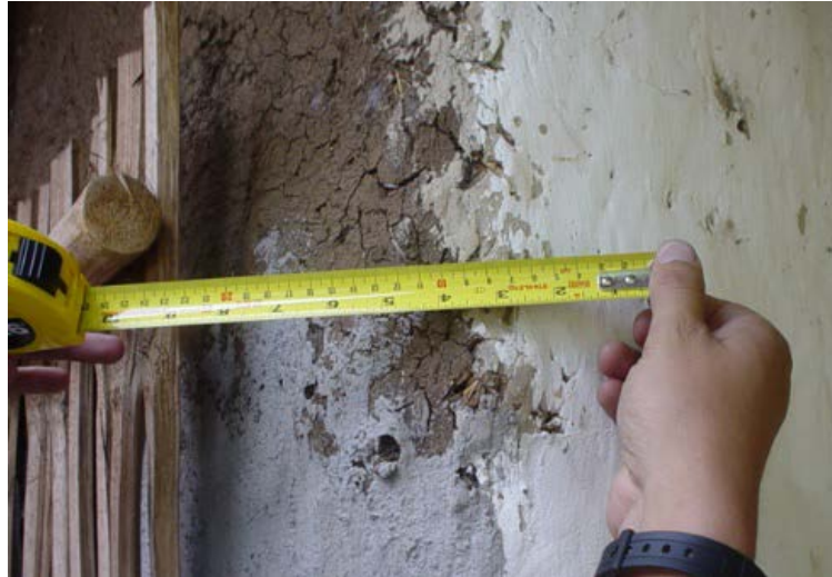
Figura 1. Grietas en los revestimientos de los muros aplicados con mezcla de tierra muy arcillosa sin arena
