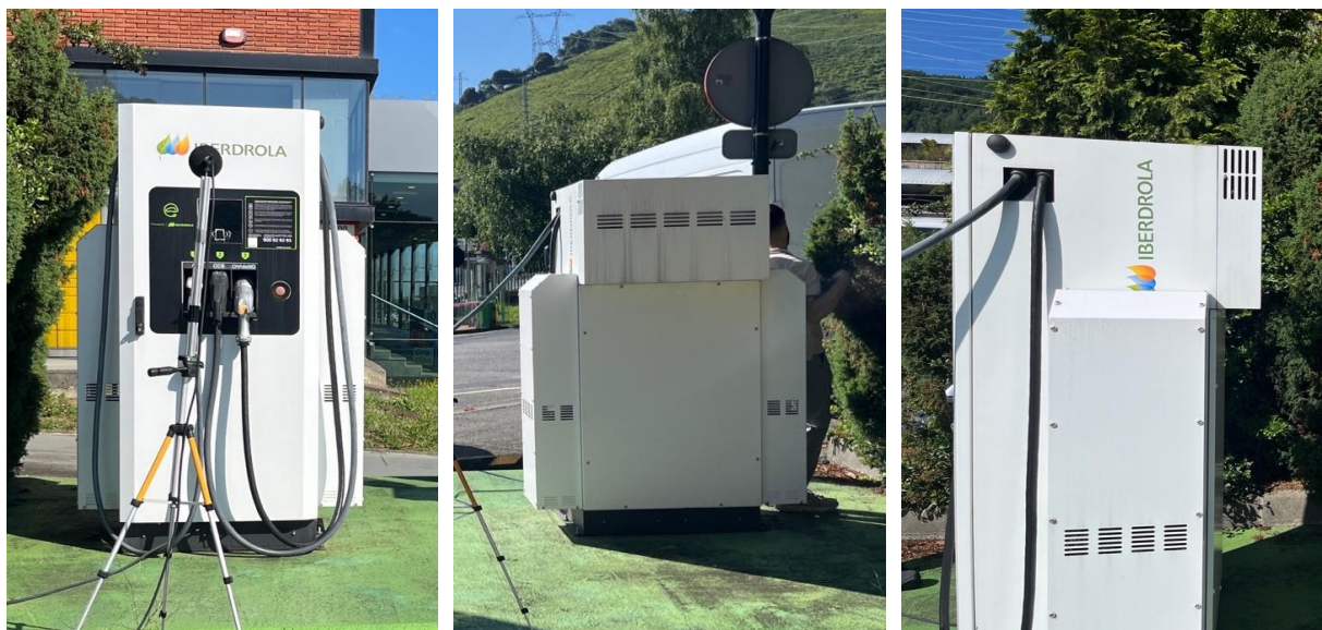
Figura 9. Estación de carga rápida Ingeteam Rapid 50 kW Trio con dispositivo de amortiguación acústica instalado
