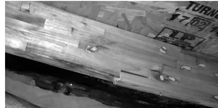
FIGURA 1. VMLE CON FALLA POR ROTURA FRÁGIL. FUENTE: ELABORACIÓN PROPIA.
