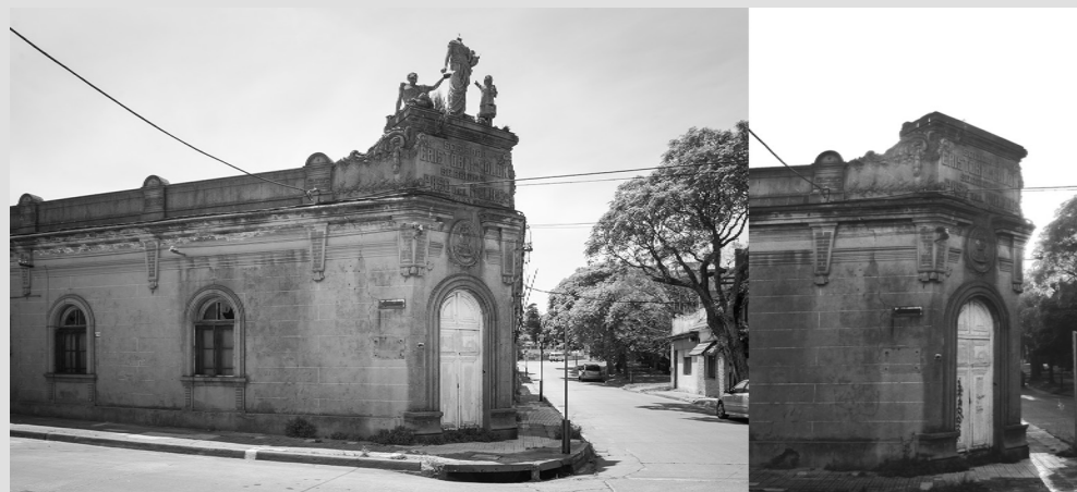
FIGURA 4. EL DETERIORO NATURAL Y LA FALTA DE MANTENIMIENTO CONDUCE INEVITABLEMENTE A PÉRDIDAS, PARCIALES Y TOTALES, DE ELEMENTOS ORNAMENTALES. EL CASO DE LA SEDE DE LA SUCURSAL PASO DEL MOLINO DE LA SOCIEDAD FILANTRÓPICA CRISTÓBAL COLÓN (1898) DA CUENTA DE ESTA SITUACIÓN QUE SE REPITE CON FRECUENCIA. EL EDIFICIO SE ENCUENTRA DESPOJADO DEL REMATE ESCULTÓRICO COMPUESTO POR LA FIGURA DE LA MUJER CON UN BEBÉ EN BRAZOS Y A SUS LADOS POR UNA NIÑA Y UN ANCIANO, AMBOS PIDIÉNDOLE AYUDA. EL CONJUNTO TENÍA UNA CLARA ALUSIÓN A LA VIRTUD DE LA CARIDAD, EN ASOCIACIÓN AL COMETIDO DE LA OBRA. FOTOGRAFÍAS DE 2018 (SMA) Y 2021 (E. BERETTA).
