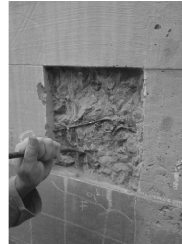
FIGURA 5. ESCARIFICACIÓN DEL ÁREA DE REPARACIÓN PARA ENSAYOS CON ARMADURA EN ÁREA DE ARREGLO EJECUTADO EN 2013. LA REPARACIÓN ILUSTRADA TIENE UNA PROFUNDIDAD DE ENTRE 20 MM A 25 MM. FUENTE: COLECCIÓN CONSERVAFU (2017).
