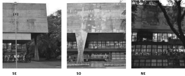
FIGURA 2. FOTOGRAFÍAS DE TRAMOS DE LAS FACHADAS CON MANCHAS DE HUMEDAD REGISTRADAS DESPUÉS DE LLUVIA DE BAJA INTENSIDAD DURANTE EL OTOÑO. FUENTE: CLAUDIA OLIVEIRA (2017).
