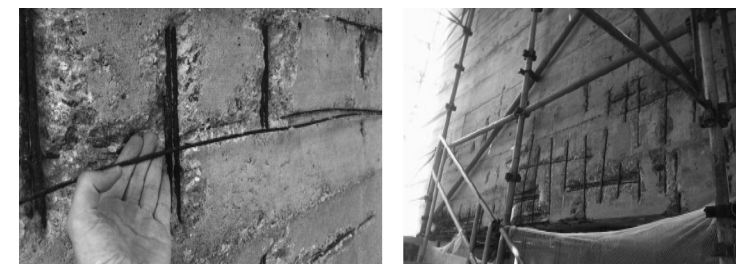
FIGURA 7. ARMADURAS CORRÓIDAS DESPUÉS DE LA REMOCIÓN DEL HORMIGÓN DESPRENDIDO. FUENTE: CLAUDIA OLIVEIRA Y RODRIGO VERGILI (2013).
