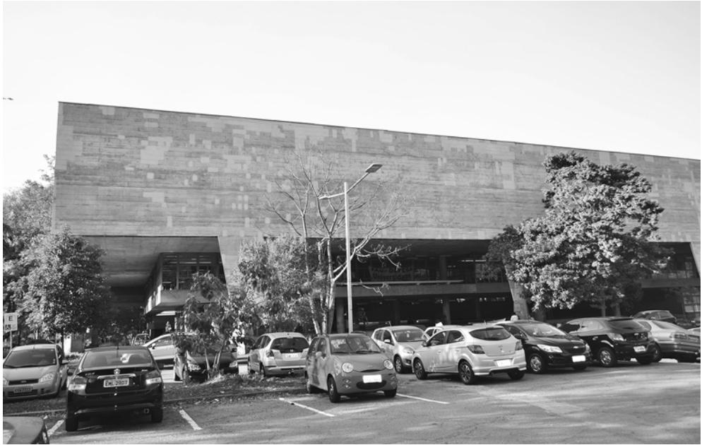
FIGURA 3. IMPACTO NEGATIVO DE LAS REPARACIONES REALIZADAS EN EL HORMIGÓN VISTO DE LAS FACHADAS DEL EDIFICIO VILANOVA ARTIGAS. FUENTE: COLECCIÓN CONSERVAFAU.
