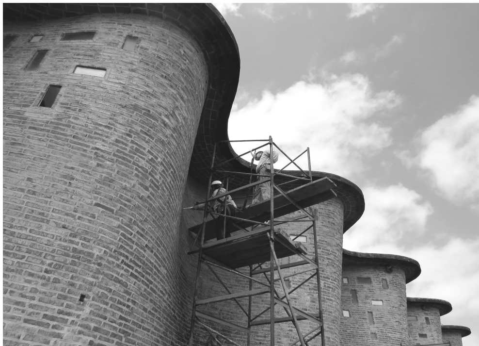
FIGURA 3: ENSAYO DE RESISTENCIA SUPERFICIAL EN LA FACHADA DE LA IGLESIA DE CRISTO OBRERO Y NUESTRA SEÑORA DE LOURDES (2016)
