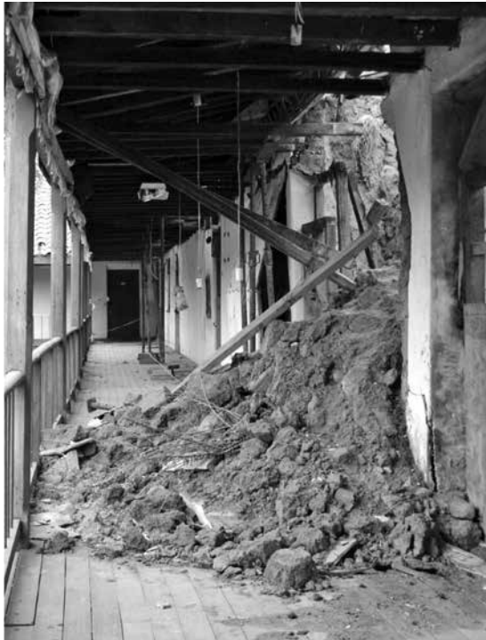
FIGURA 2. MURO EJE N° 9 CON COLAPSO PARCIAL. LA TIERRA PRESENTE EN EL SISTEMA CONSTRUCTIVO DE ADOBE SE UTILIZÓ PARA LAS INTERVENCIONES EN EL MISMO EDIFICIO. FUENTE: FOTOGRAFÍA DEL AUTOR DEL ARTÍCULO
