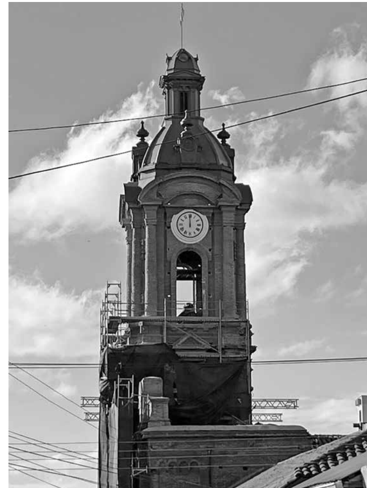
FIGURA 8. IMAGEN QUE MUESTRA LA TORRE DE LA IGLESIA SAN FRANCISCO DE BARÓN EN PROCESO DE RESTAURACIÓN. FUENTE: FOTOGRAFÍA DEL AUTOR DEL ARTÍCULO
