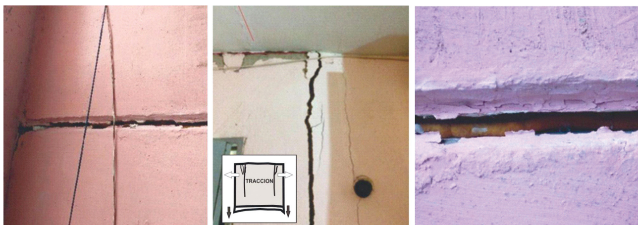
FIGURA 8. En estas imágenes se observan los efectos del tránsito vehicular ( bypass de Pando) que generó rupturas en las conexiones cubierta–estructura, separación de paneles y grietas verticales producidas por deformaciones transversales. En la imagen del centro se observa una importante grieta vertical con aparente dirección de propagación hacia el piso (fotos gentileza Arq. Antonella Muniz).
