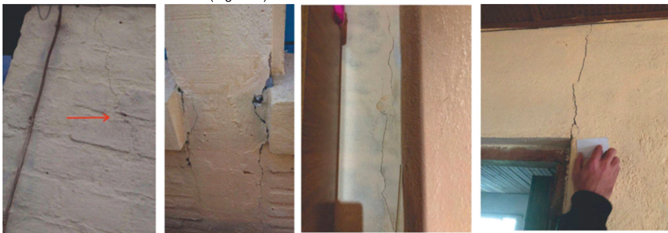
FIGURA 6. Ejemplos de rajaduras y roturas visibles dentro y fuera de una escuela en la localidad de Paraje Minuano (Colonia) debido a voladuras en cantera (Sánchez Bettucci et al. , 2018).
