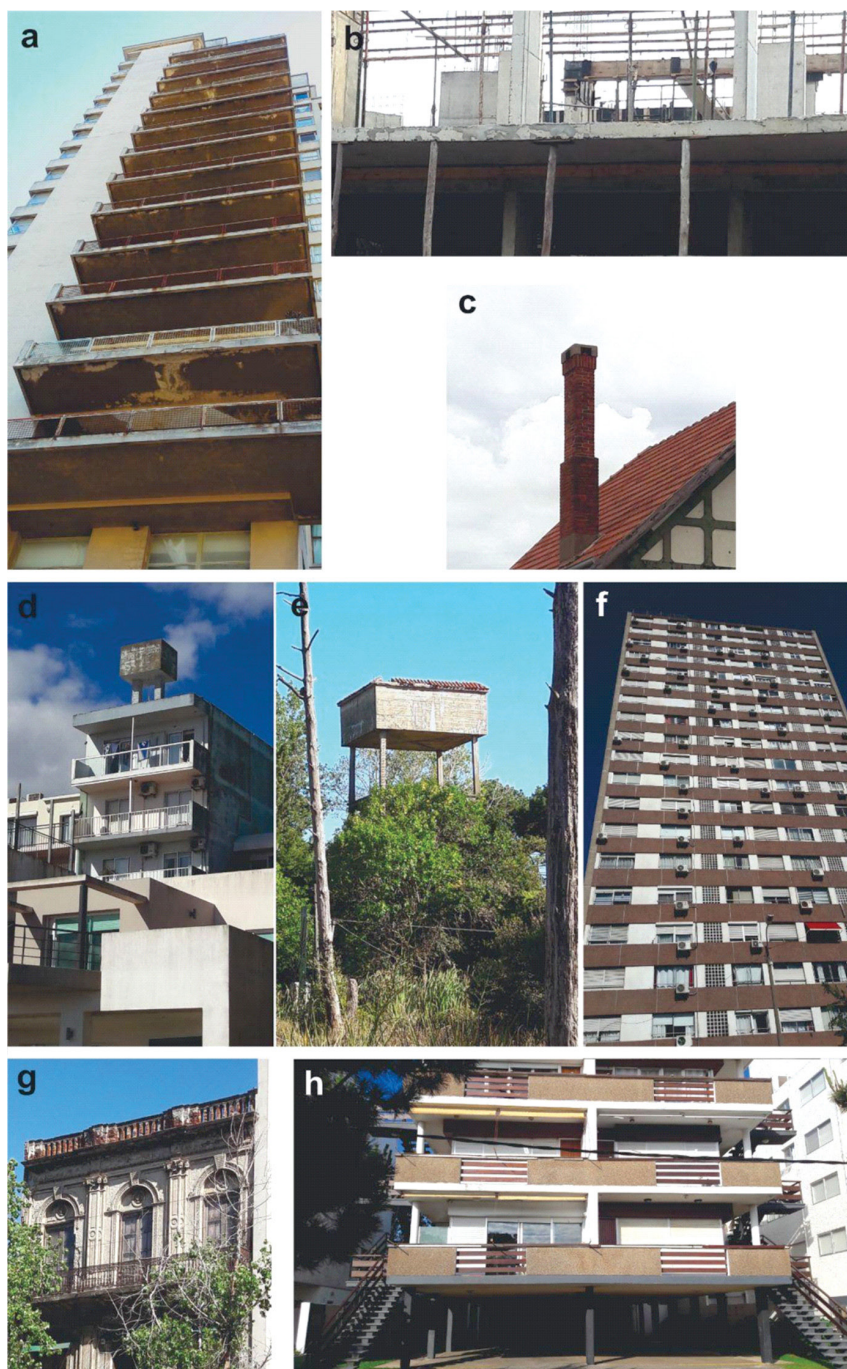
FIGURA 9. Algunos ejemplos de construcciones que podrían volverse peligrosas en el caso de un terremoto M=5.8 , similar al de 1888, cercano: a) balcones en voladizo con penetración de agua y refuerzo corroído: una falla podría provocar varias más, b) losa en voladizo sin viga anular y hormigón con deficiente compactación, mal reparada, que podría provocar corrosión y fallas tempranas, c) chimenea de ladrillo que puede caer y tejas cerámicas pesadas que pueden aflojarse y deslizarse, d) tanque de agua de hormigón sobre columnas delgadas con poca resistencia a la flexión, e) torre de agua con poca resistencia a la torsión o flexión (y baldosas cerámicas sueltas), f) unidades de aire acondicionado externas, muchas sin fijación, g) balastrada de ladrillo y balcones de hormigón en voladizo con refuerzo corroído, h) diseño de “piso suave” con baja resistencia al cizallamiento y la torsión.
